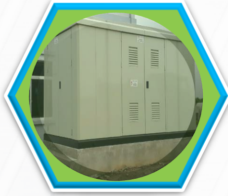
TRẠM HỢP BỘ
